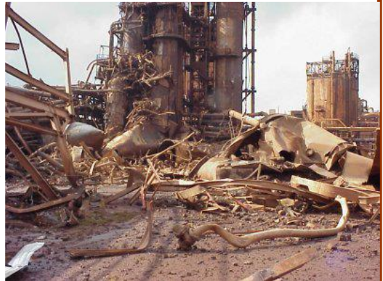
Schade tengevolge een BLEVE
