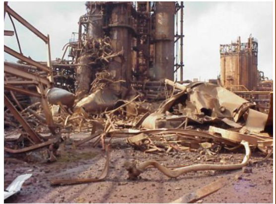
תוצאות ה-BLEVE מקור: דוח אירוע של MSHA מיום 5 ביולי 1999 MSHA ID No. 16-00352
