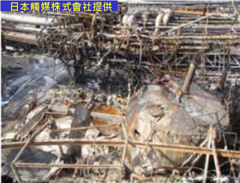
照片 1：受損的AA儲槽
