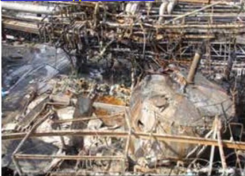
Figura 1: Tanque de AA destruído
