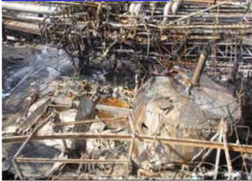
Photo 1 : Réservoir d'AA détruit
