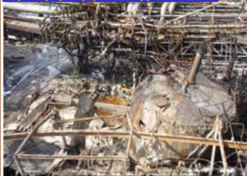
Φωτογραφία 1: Κατεστραμμένη δεξαμενή ΑΟ
