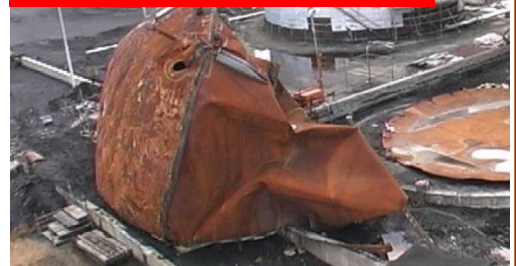
Εικ. 2: Δεξαμενές hot oil
