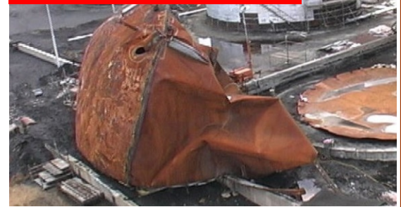
Fig. 2: Tanke med varm olie
