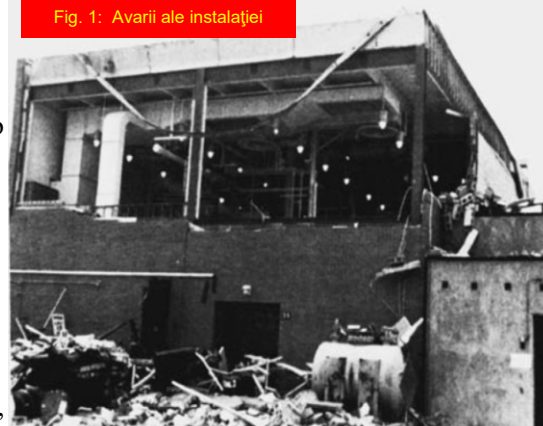
Fig. 1: Avarii ale instalației
