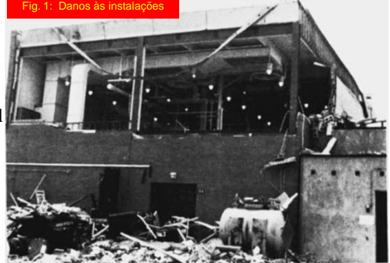
Fig. 1: Danos às instalações
