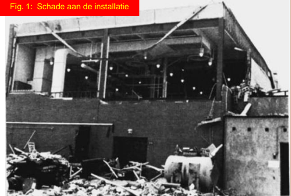
Fig. 1: Schade aan de installatie
