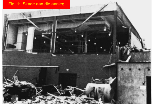
Fig. 1: Skade aan die aanleg
