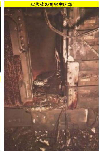
火災後の司令室内部
