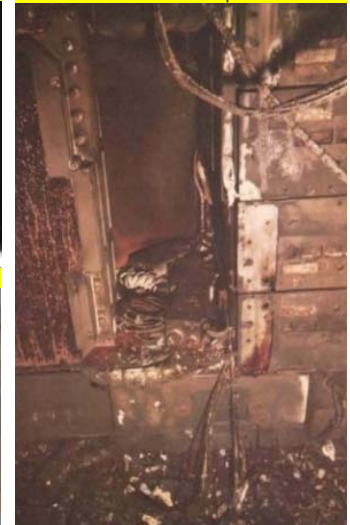
L'intérieur du module après le feu
