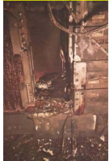
Section intérieure du MC après l'incendie
