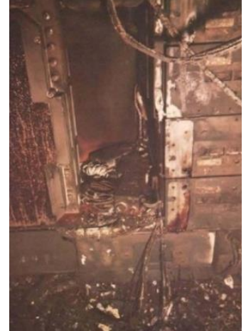
Τμήμα από το εσωτερικό του CM μετά την πυρκαγιά
